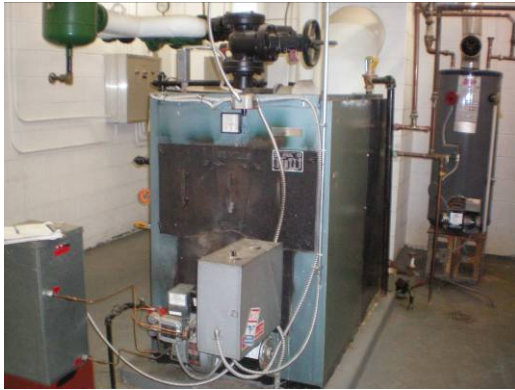
Existing Commons Hot Water Boiler
